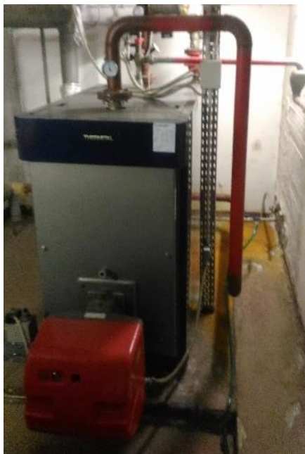
Figura 4.8 - Particolare della caldaia
